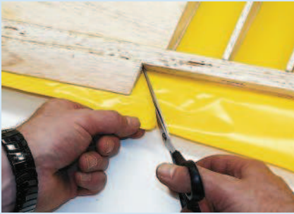
Abb. 12a Für Ecken an der Innenseite erst in einem Winkel von 45° einschneiden.
